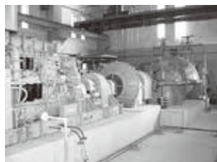
楠部第2排水機場
